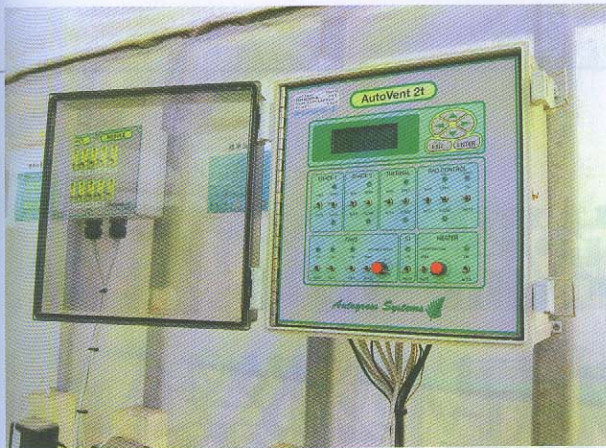
▲皇基於2006年中旬導入微電腦環控主機，串連既有電控箱，負責控制溫室內的環境調節設備。
